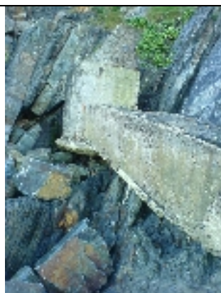
conduite dans le vide
