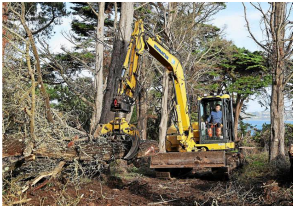
Fermé depuis un an à la suite de la chute de 200 arbres, le parc départemental du Dourven, à Trédrez-Loquémau (22), est en voie de réhabilitation. Le parc devrait rouvrir en février 2025, et la troisième phase, celle de la replantation et de l'aménagement, devrait débuter à l'automne prochain. Photo Lionel Le Saux
